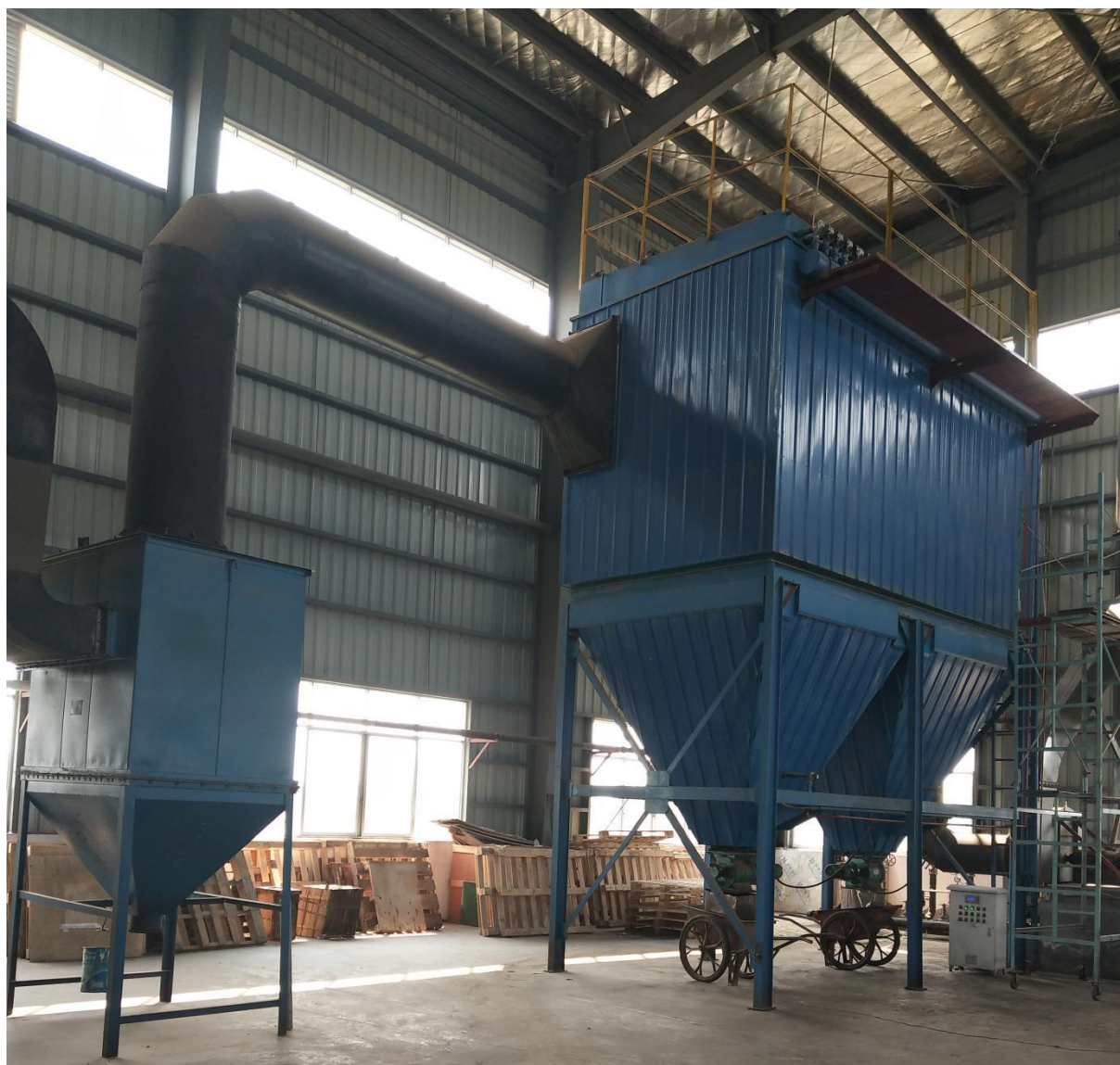
图 4-1 锅炉废气治理设施图片
